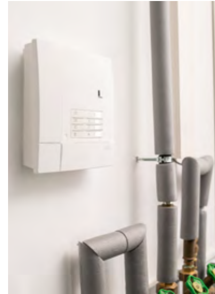
↗ Zentrale einer Alarmanlage im Haustechnikraum
